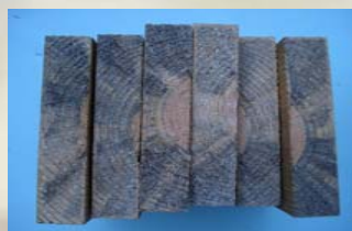
Foto 5: Presencia de hongos
