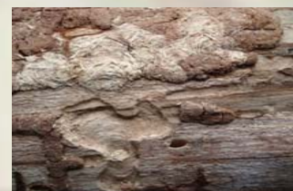
Foto 6: Presencia de galerías
